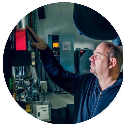
Urs Schneider jette un œil à la pompe à chaleur située au deuxième sous-sol du site et véritable clef de voûte du système de chauffage et de climatisation.
