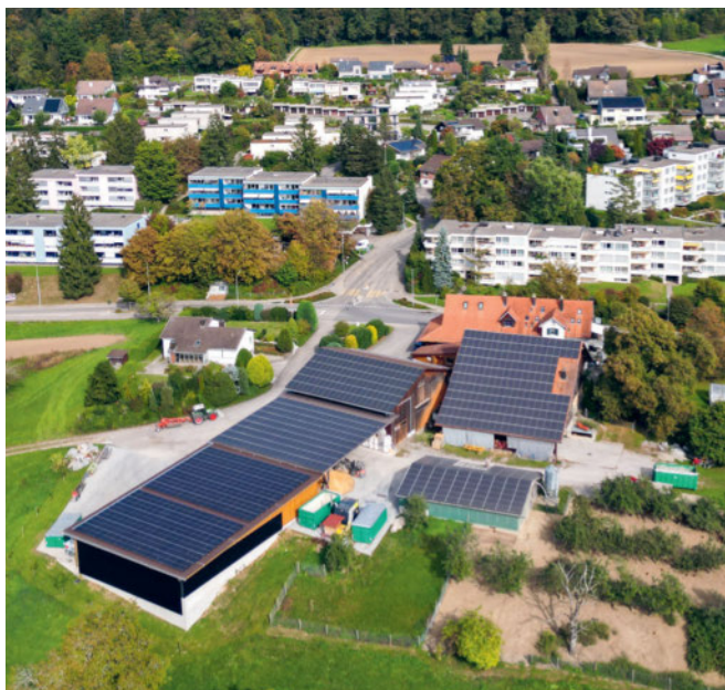
Installés à la fois sur les toits et les façades, les modules permettent une production d'énergie constante.
